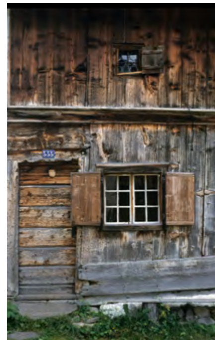
Widerstandsfähige Häuser aus Holz. Alpenländische Bauweisen trotzen Wind und Wetter über Jahrhunderte hinweg
